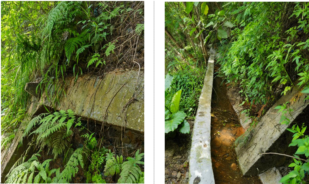
一、二级坡面渗水明显
