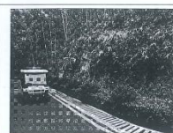
照片 4 边坡中段发生崩塌
