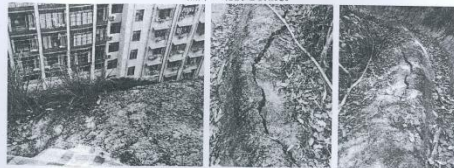
照片3 边坡坡顶护面开裂
