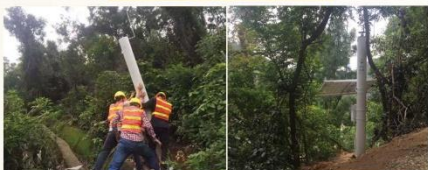
GNSS监测点安装
