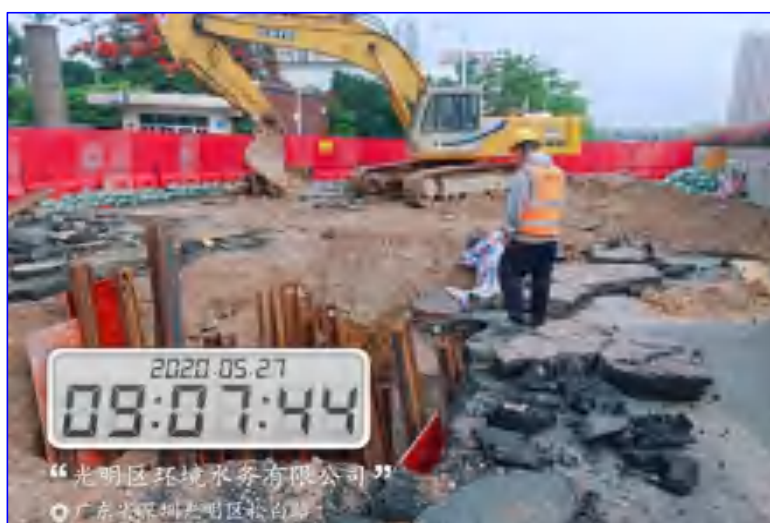
松白路辅路源丰塑胶制品厂门口地面坍塌现场照片
