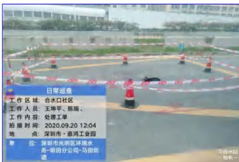
松白路辅路中粮云景花园处地面坍塌现场照片
