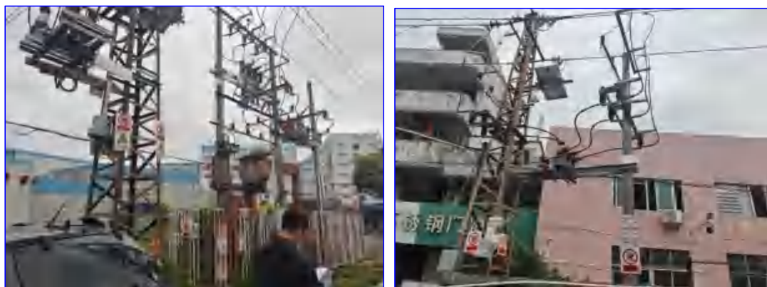
施工周边存在多处变电站
