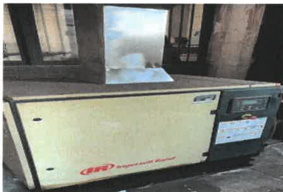
图 20: 螺杆空压机 用途: 制造空气压力
