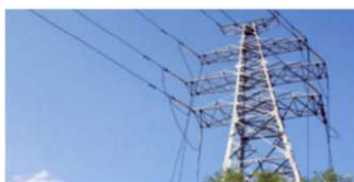
国家电网、电力公司-输变电项目
