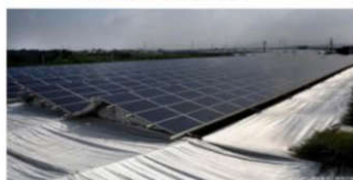
河北省黄骅市吕桥镇渔光互补光伏发电项目
