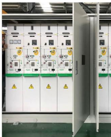
生产户外开闭所
