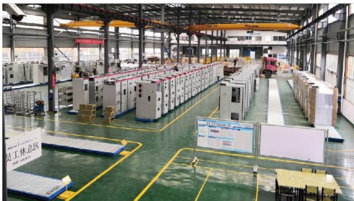
电力产品装备现场
