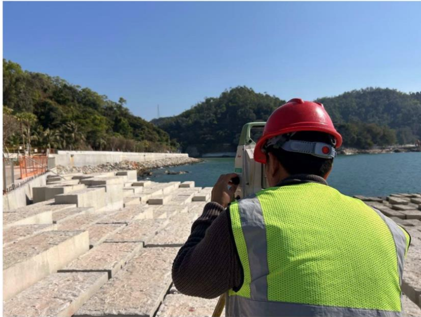
图 2 东部海堤现状（沙鱼涌）
