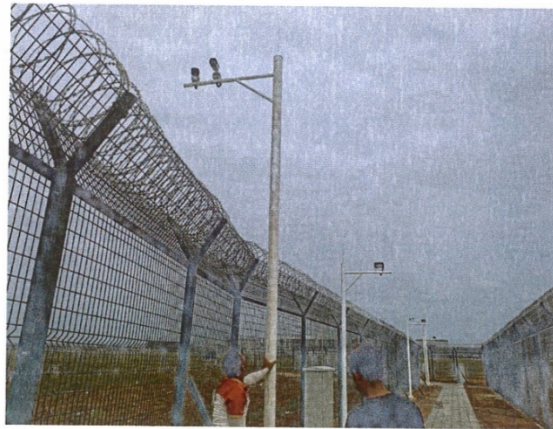
南端围界拐弯处安装枪机补盲
