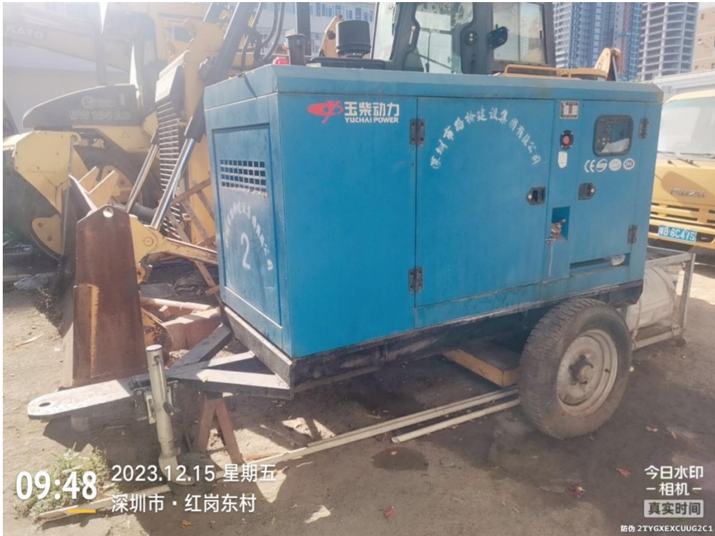
50kw 发电机照片
