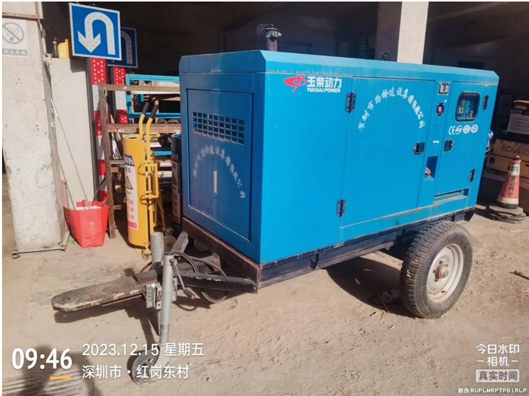
40kw 发电机照片
