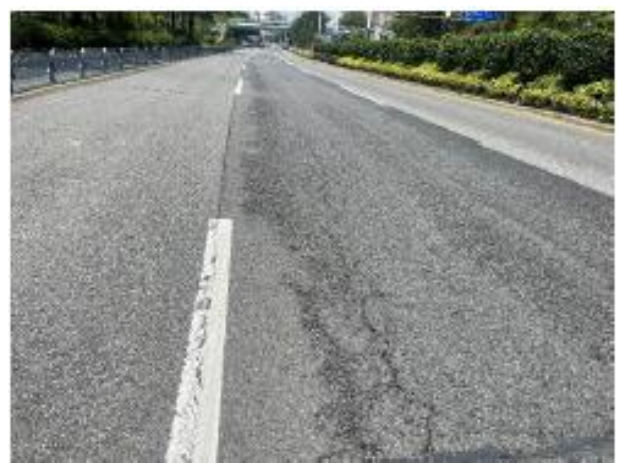
沥青路面横纵向裂缝
