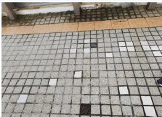
比亚迪天桥现状瓷砖脱落、防滑性差
