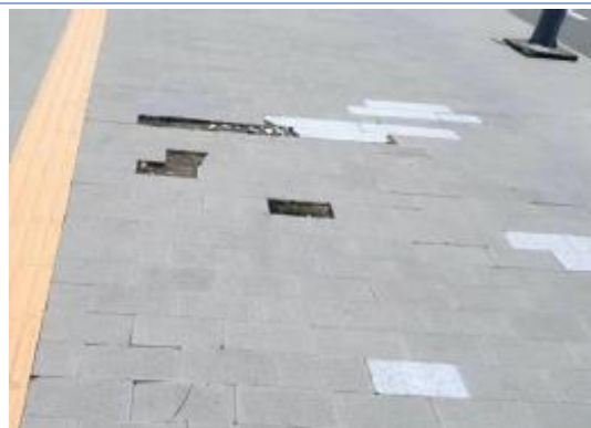
现状桥梁人行道磨损严重、瓷砖掉落、防滑性能差
