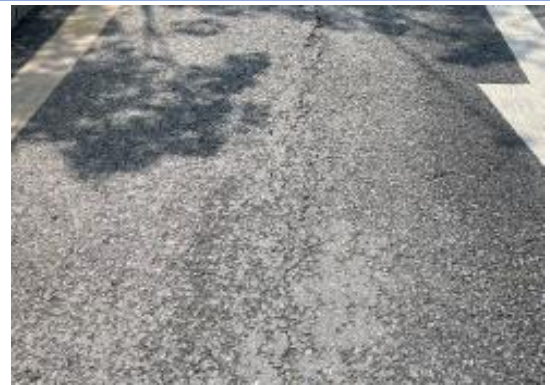
沥青路面横纵向裂缝
