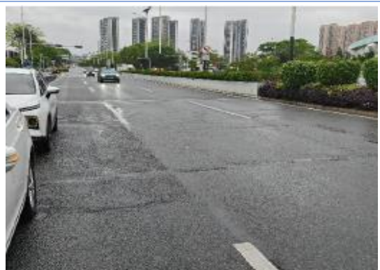
赤坳中桥等桥面沥青路面病害
