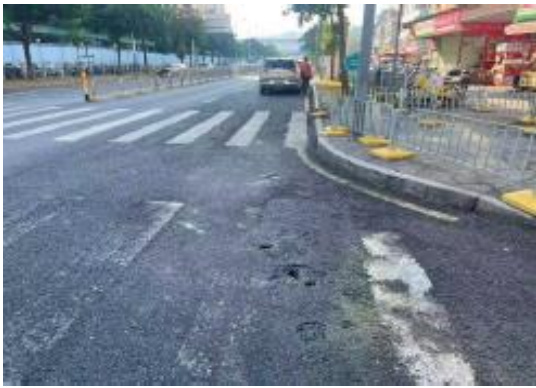
沥青路面坑槽
