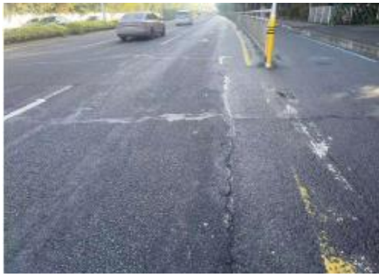
沥青路面横纵向裂缝
