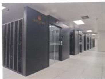
▲ 数据中心主机房
