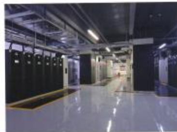
▲ 数据中心配电房
