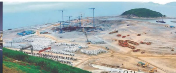
福建宁德核电站
