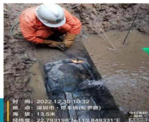
DN1000钢管爆裂抢修
