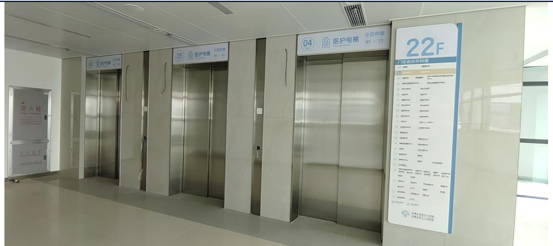
龙岗中心医院外科综合楼工程标识标牌系统采购及安装—项目实景照片
