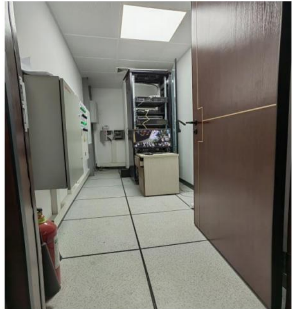
(集团总部中心机房 2)
