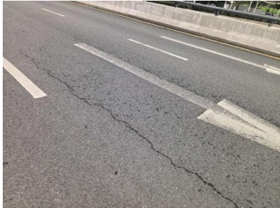
现状道路开裂
