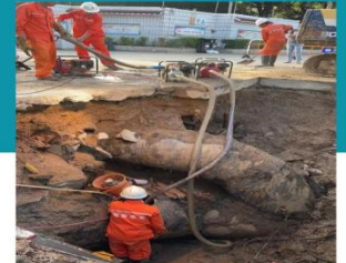
燕罗水厂内DN1000三通 钢管爆裂抢修
