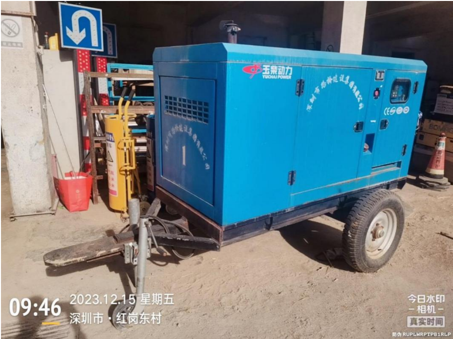
40kw 发电机照片
