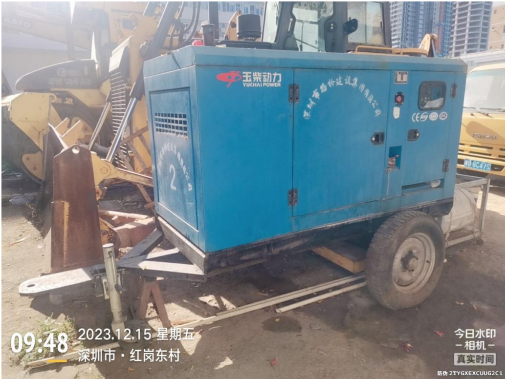
50kw 发电机照片
