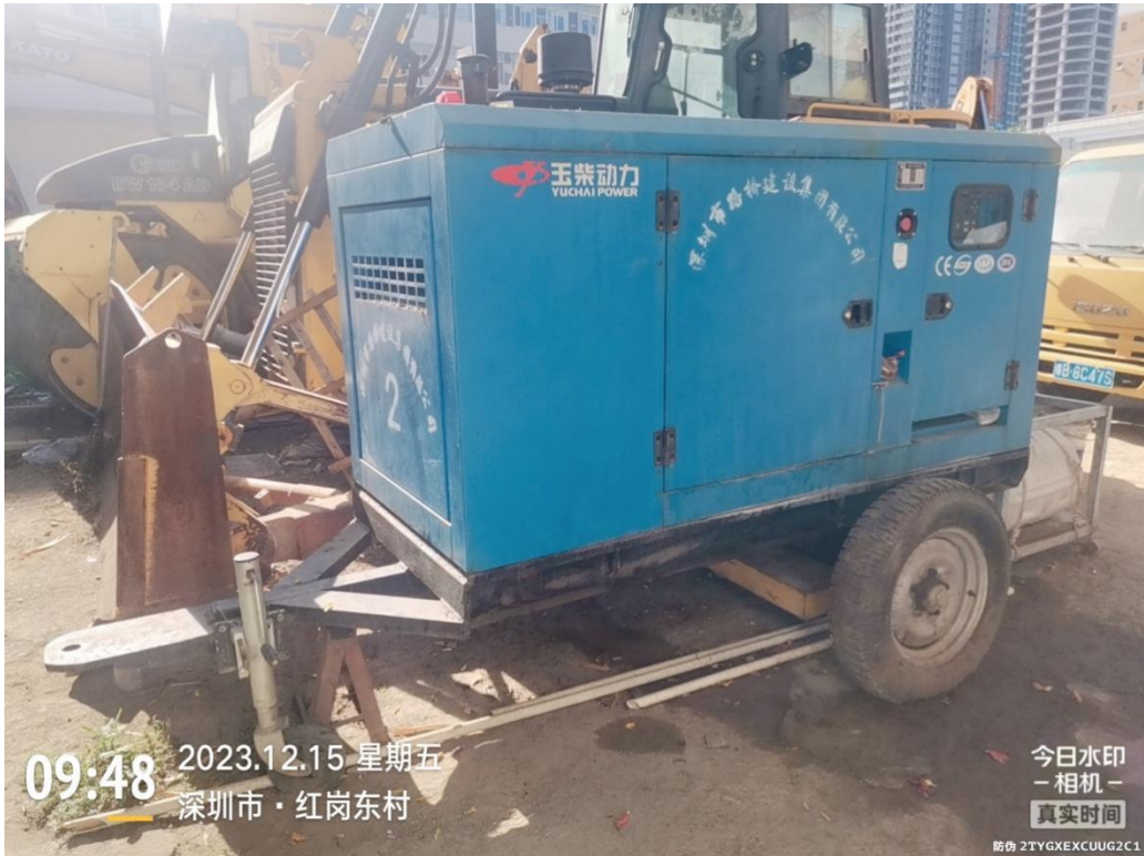
50kw 发电机照片
