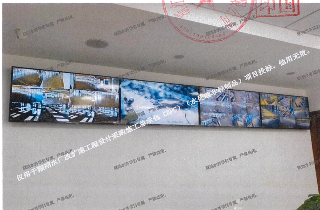
调度中心：无死角监控
