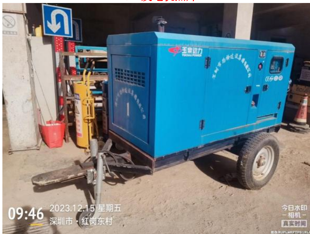
40kw发电机照片
