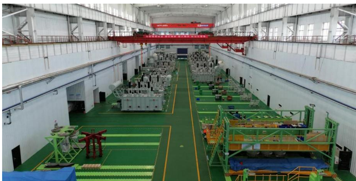
● 110kV 变压器装配区
