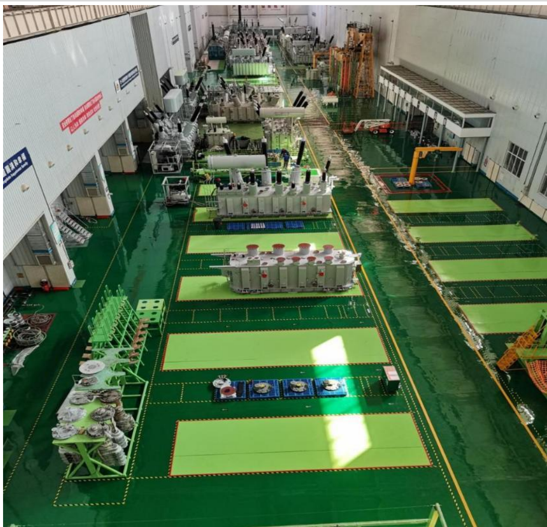
● 220kV-1000kV 变压器装配区
