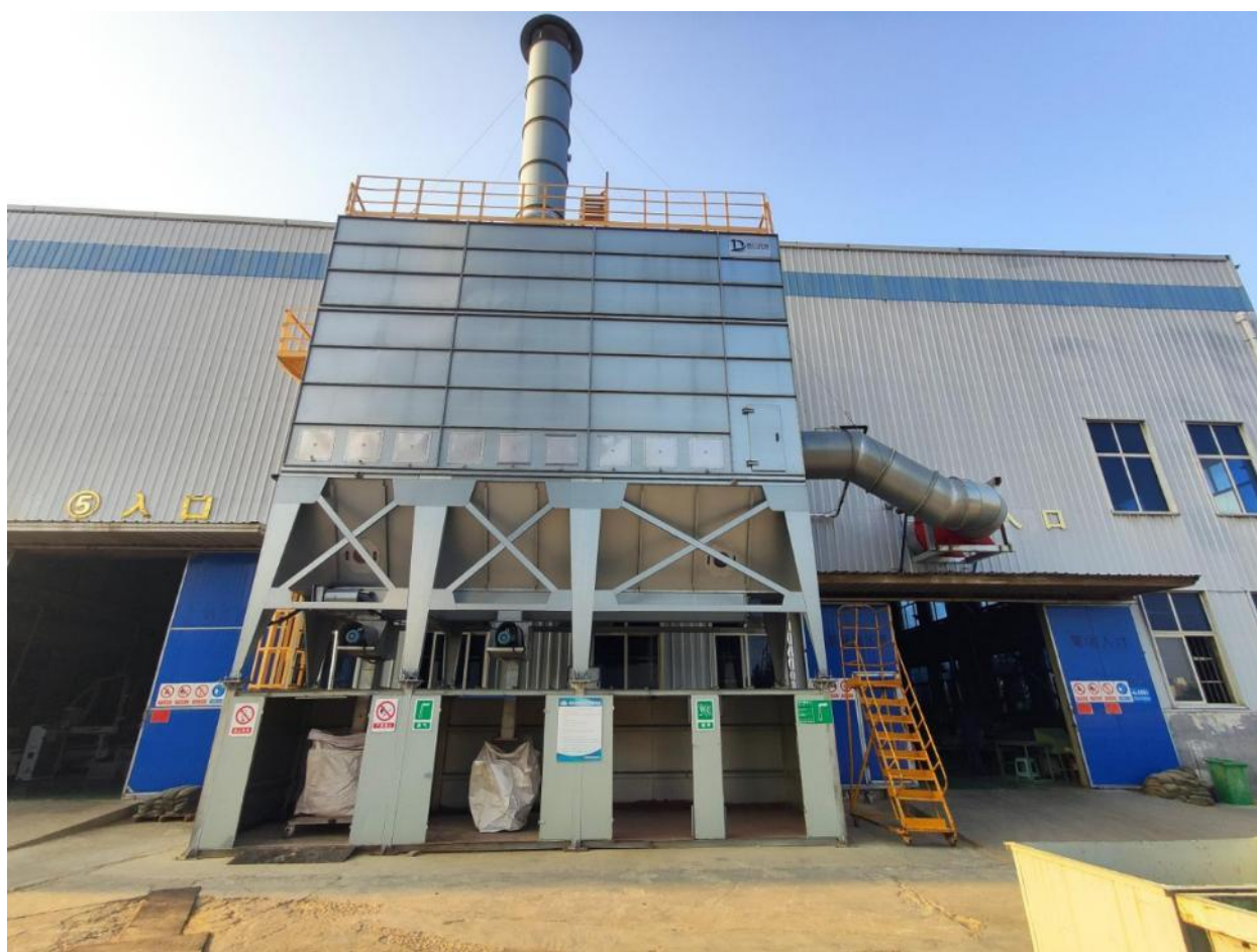
绝缘车间集中除尘装置
