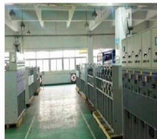
环网柜组装车间
