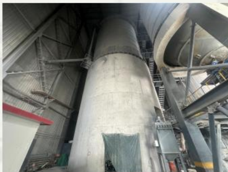
白音呼布矿业充填站 2# 砂仓
