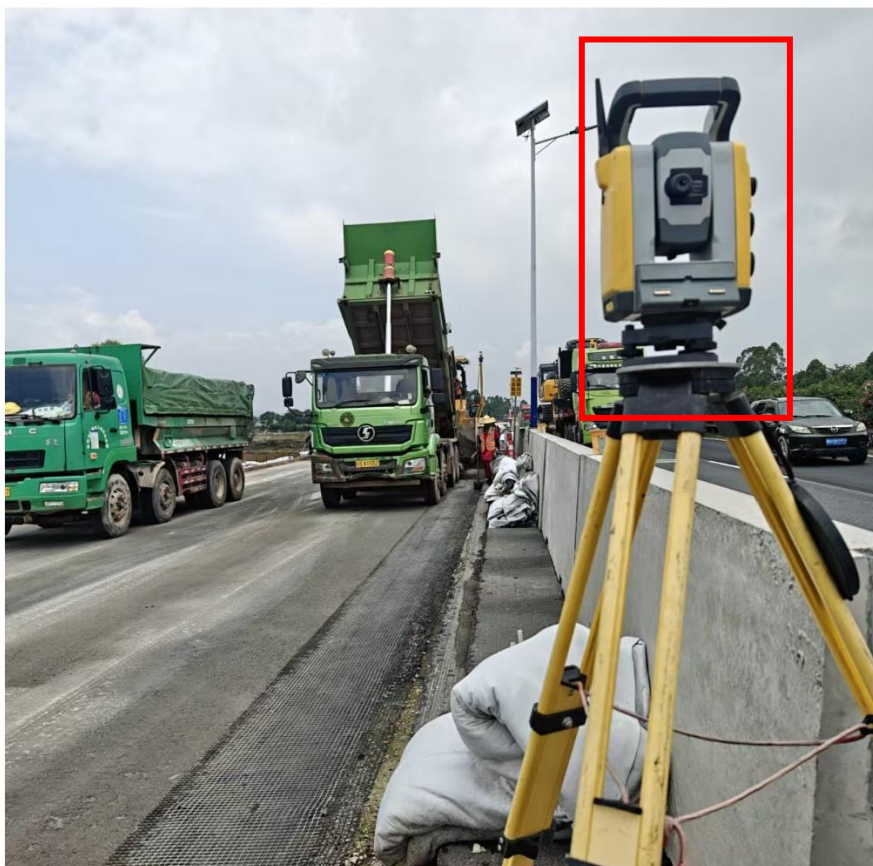
设备照片（天宝 SCS900, 3D 数字化智能控制系统）
