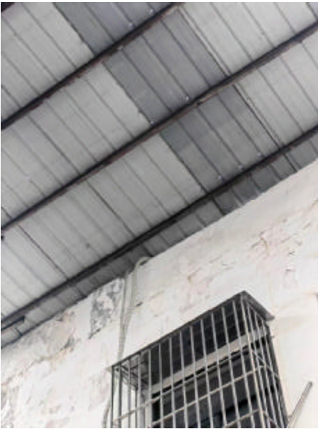
现场漏水照片
