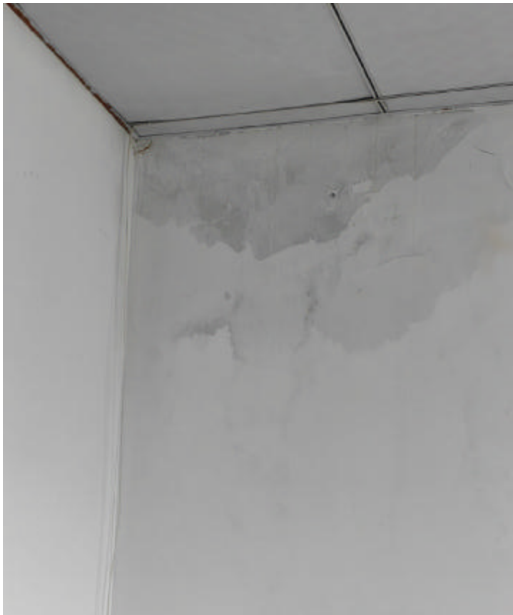
现场漏水照片2
