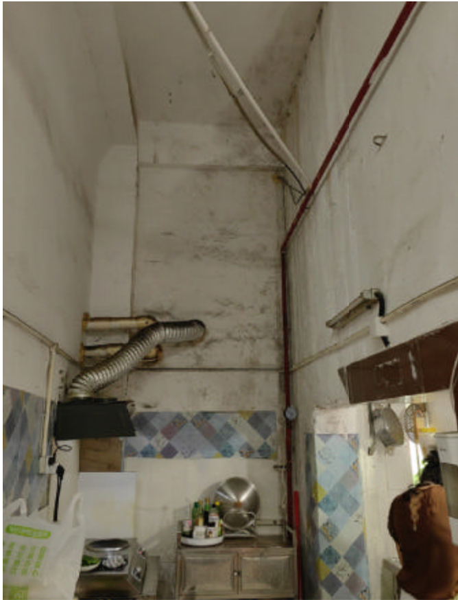
现场漏水照片1
